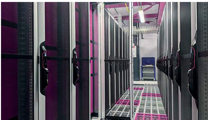
Дата-центр «Миран», Санкт-Петербург
