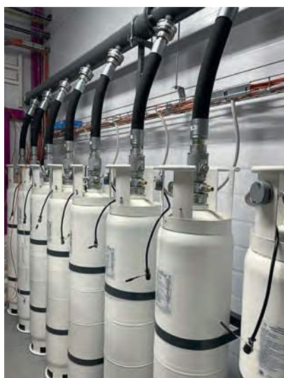
Система ГПТ с Хладоном 125 производства «НПО Пожарная автоматика сервис» в ЦОД «Миран»
